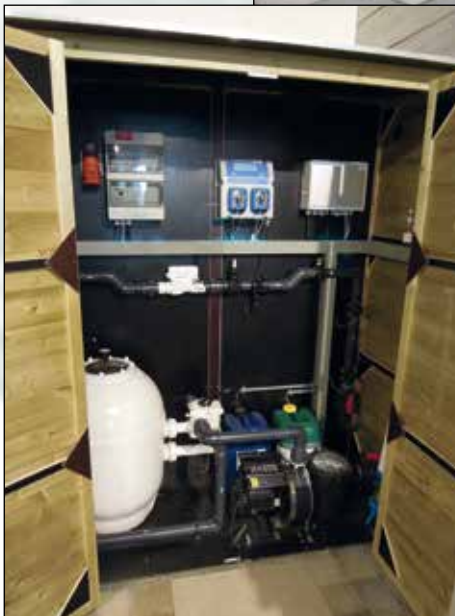
techno kast voor zwembadinstallatie Sint-Oedenrode
